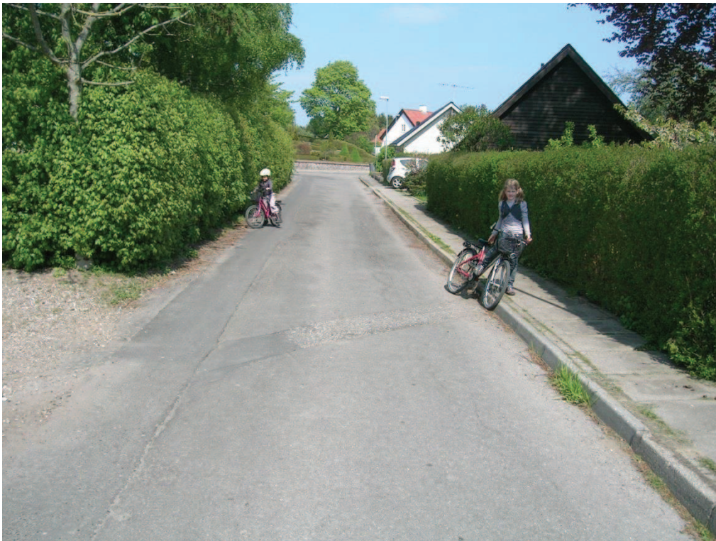
Eksempel 2. Trafikklasse T1 Restlevetid: 29 %
